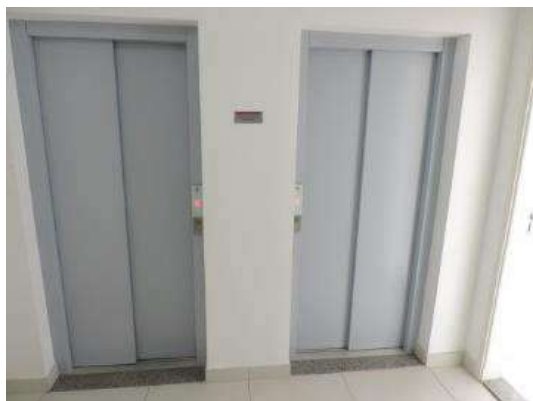
Imagem 74 – hall de elevadores, imóvel 02
