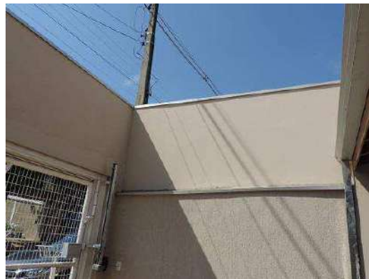
Imagem 67 – poste de entrada de energia, imóvel 01
